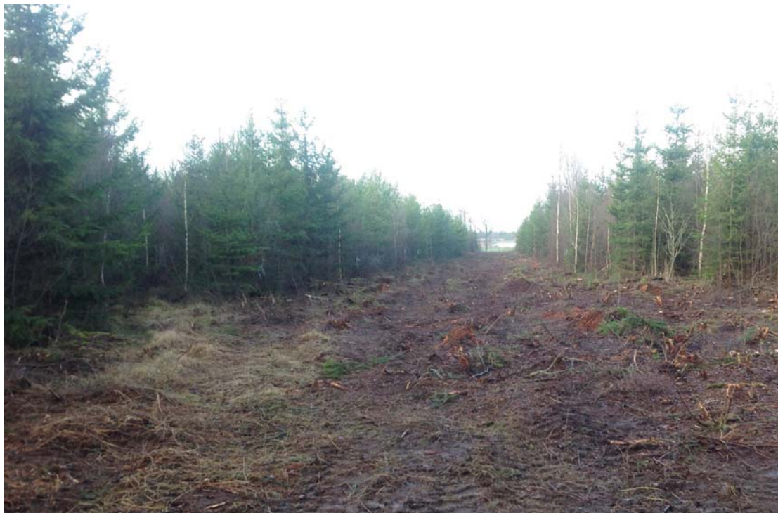
På delar av markkabelsträckan är arbetsområdet nu färdigröjt och klart för byggstart. Den slutliga kabelgatan kommer att bli omkring 10 meter bred.
