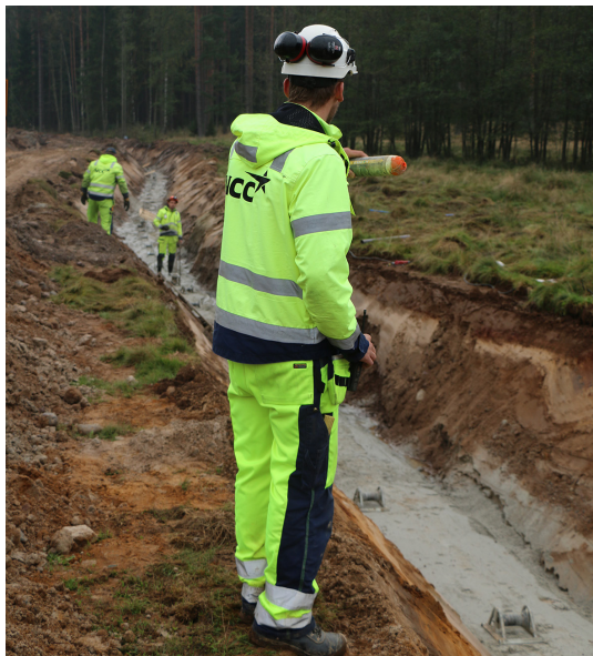
NCC följer tidsplanen och beroende på vädret kommer de att hinna fram till Nybro station innan marken fryser.
