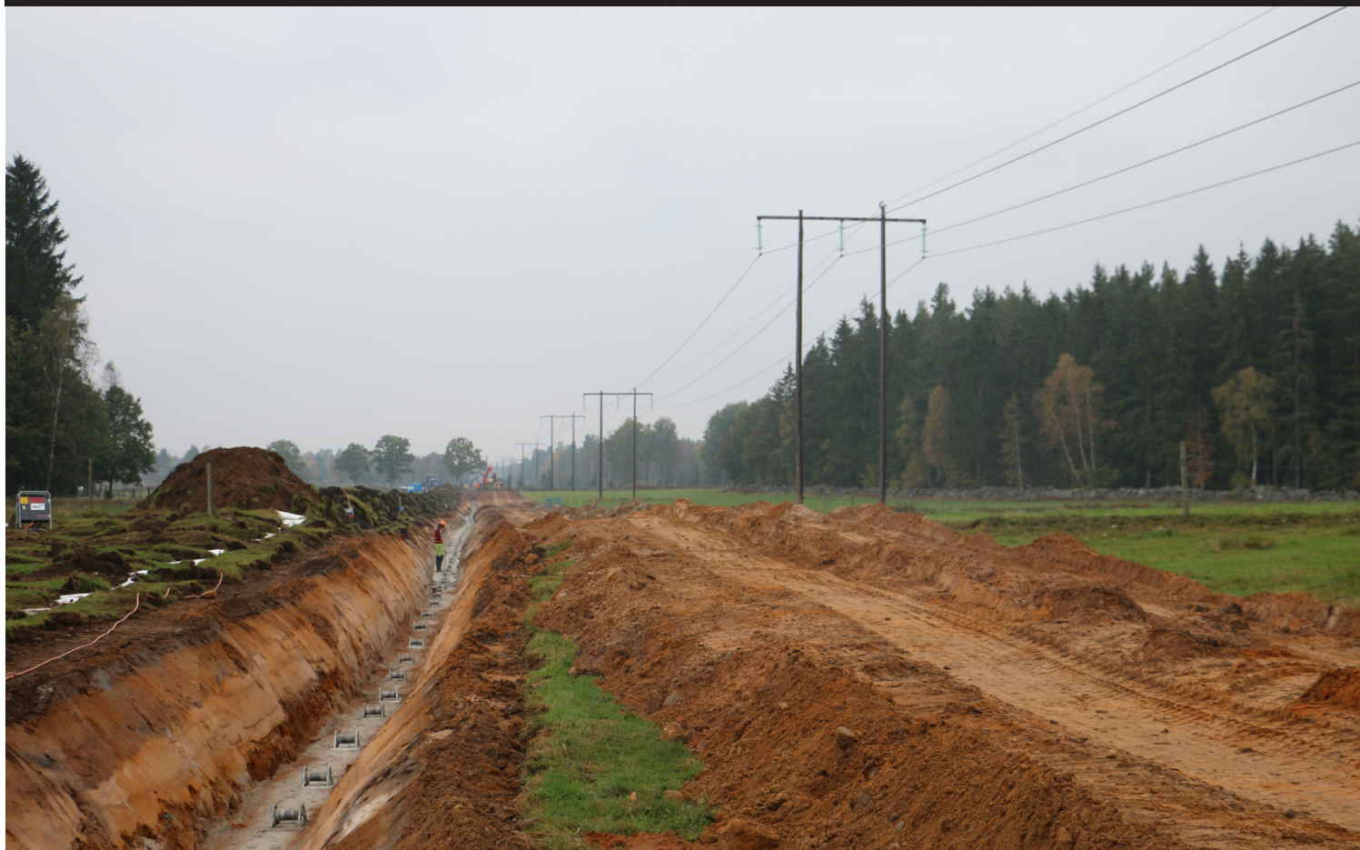
Arbetet med att gräva ner NordBalt har nu passerat Persmåla. Foto: Elin Drugge.
