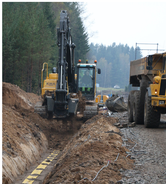
Kablarna täcks först med en värmeledande sand, ovanpå det ett skyddsband och överst schaktmassorna.
